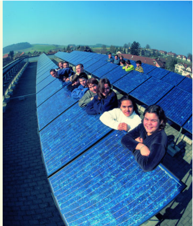
Aufgeständerte Solarstrommodule auf dem Flachdach eines Schulhauses. (Patrick Lüthy)
